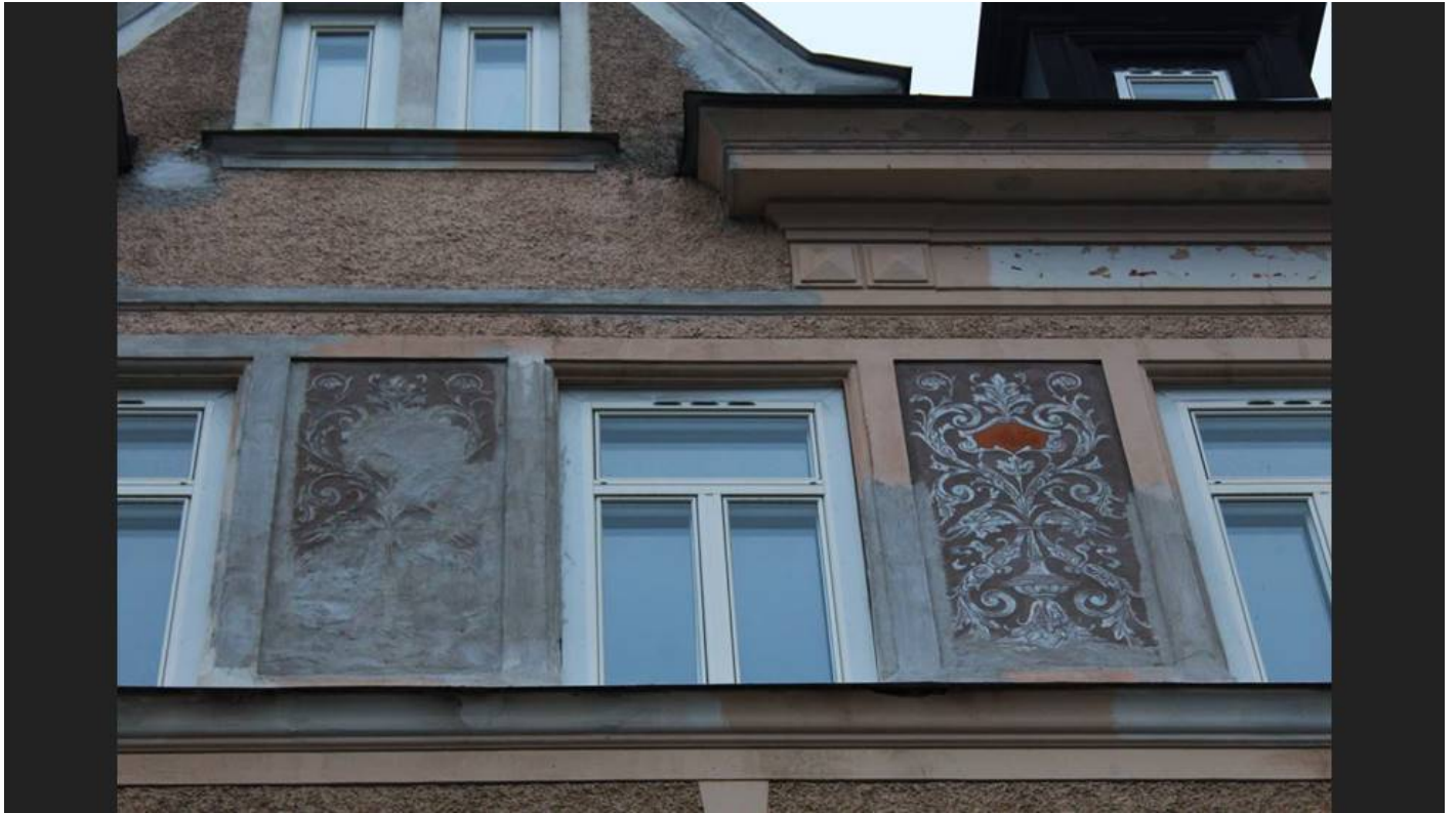
BILD: Gunnar Hagberg | Utmed Norra Promenaden har fasadarbetet ännu inte påbörjats. I vår kommer även de målningarna att vara som nya igen.
